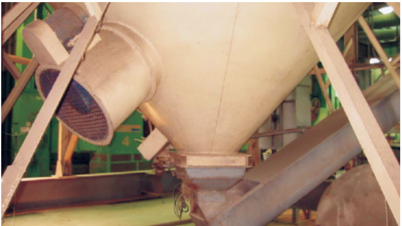
圖 20. 筒倉常溫通風機（軸流式風機位於筒倉尖底左側）
