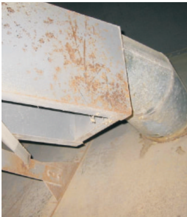
圖 17. 鋼板方型筒倉倉內底部通風管
